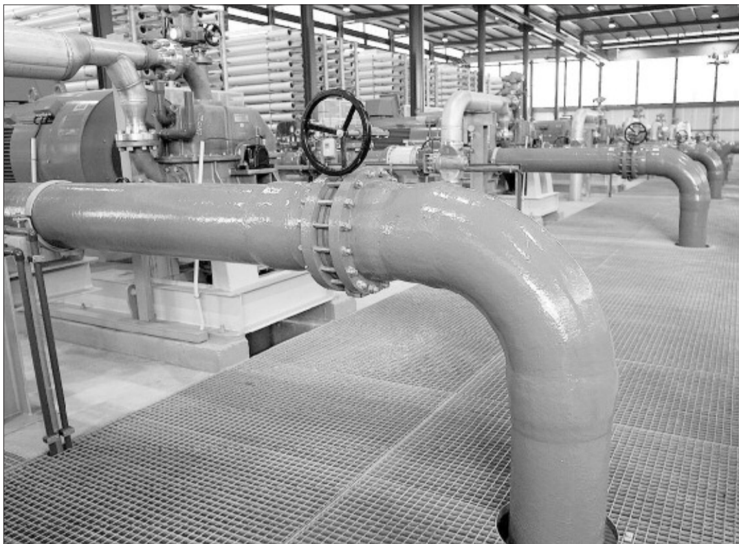
Interior de la planta desaladora de Agua Amarga, en Alicante. / OLIVARES NAVARRO
